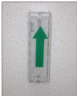
Obr. 5: Detail nouzového osvětlení.
